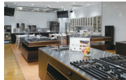
東邦ガス厨房設備
